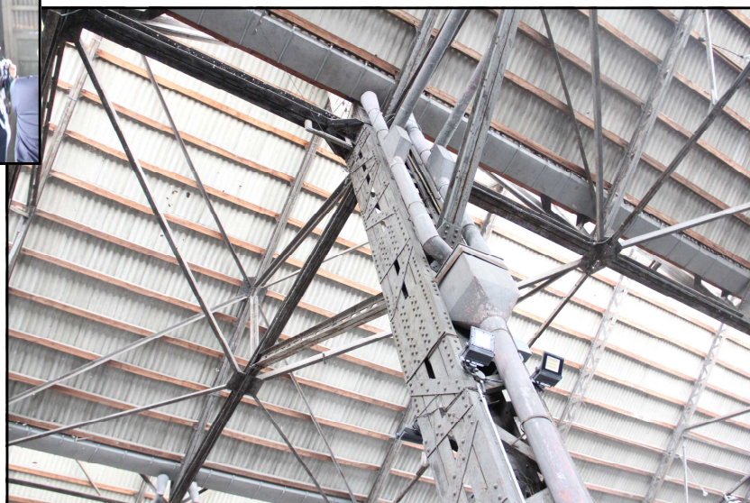
□旧第一組立工場の建物北側内部 扉部の内側構造と天井部の柱材 建物中央部の柱材と天井部トラス構造
