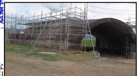
□大刀洗北飛行場中型有蓋掩体の公開に向けての整備様子 福岡県甘木市大刀洗町
