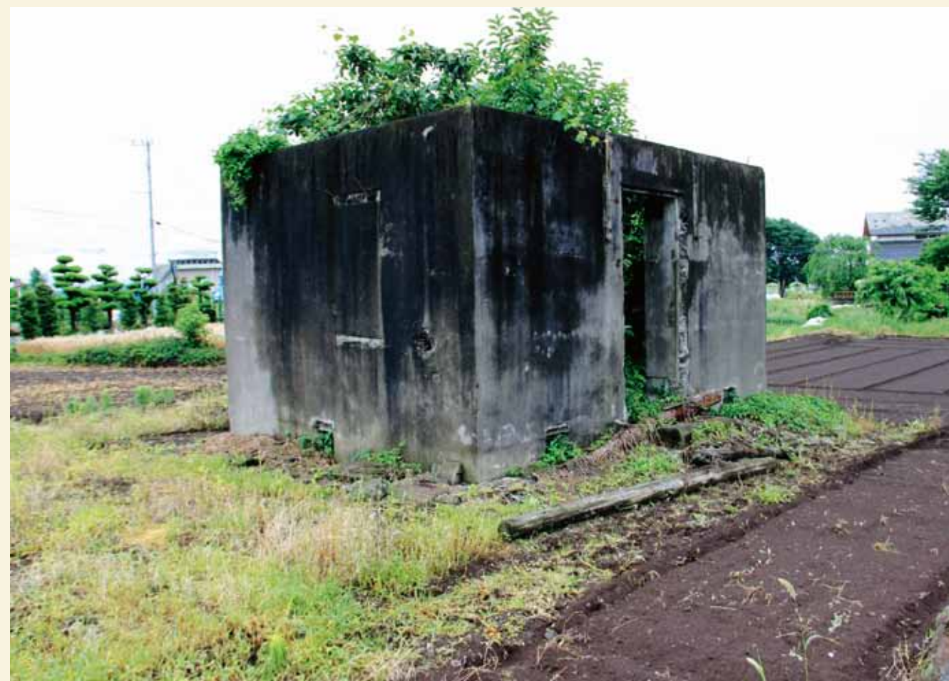
地震で正面上部に亀裂が入る
