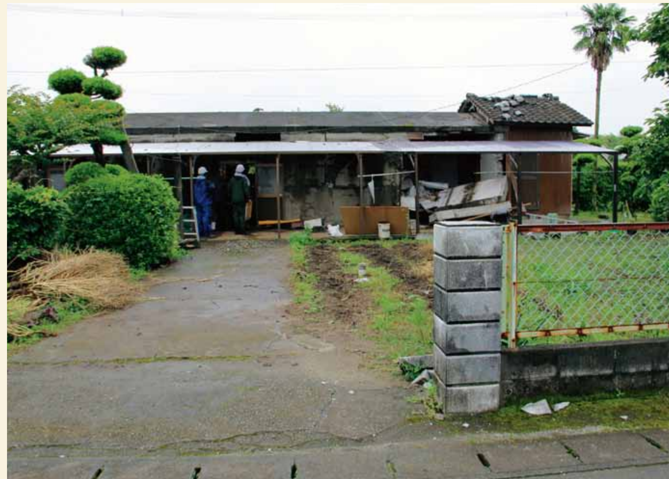
西側被災の様子
