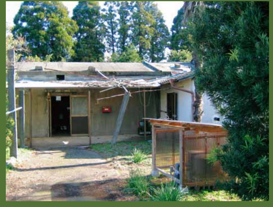
地震前の油倉庫の様子
