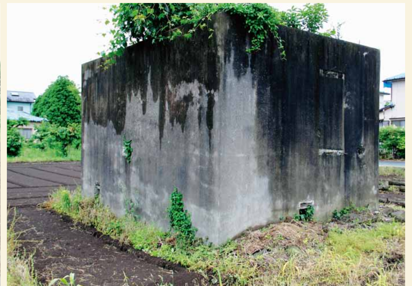
裏面への被害は見られない
