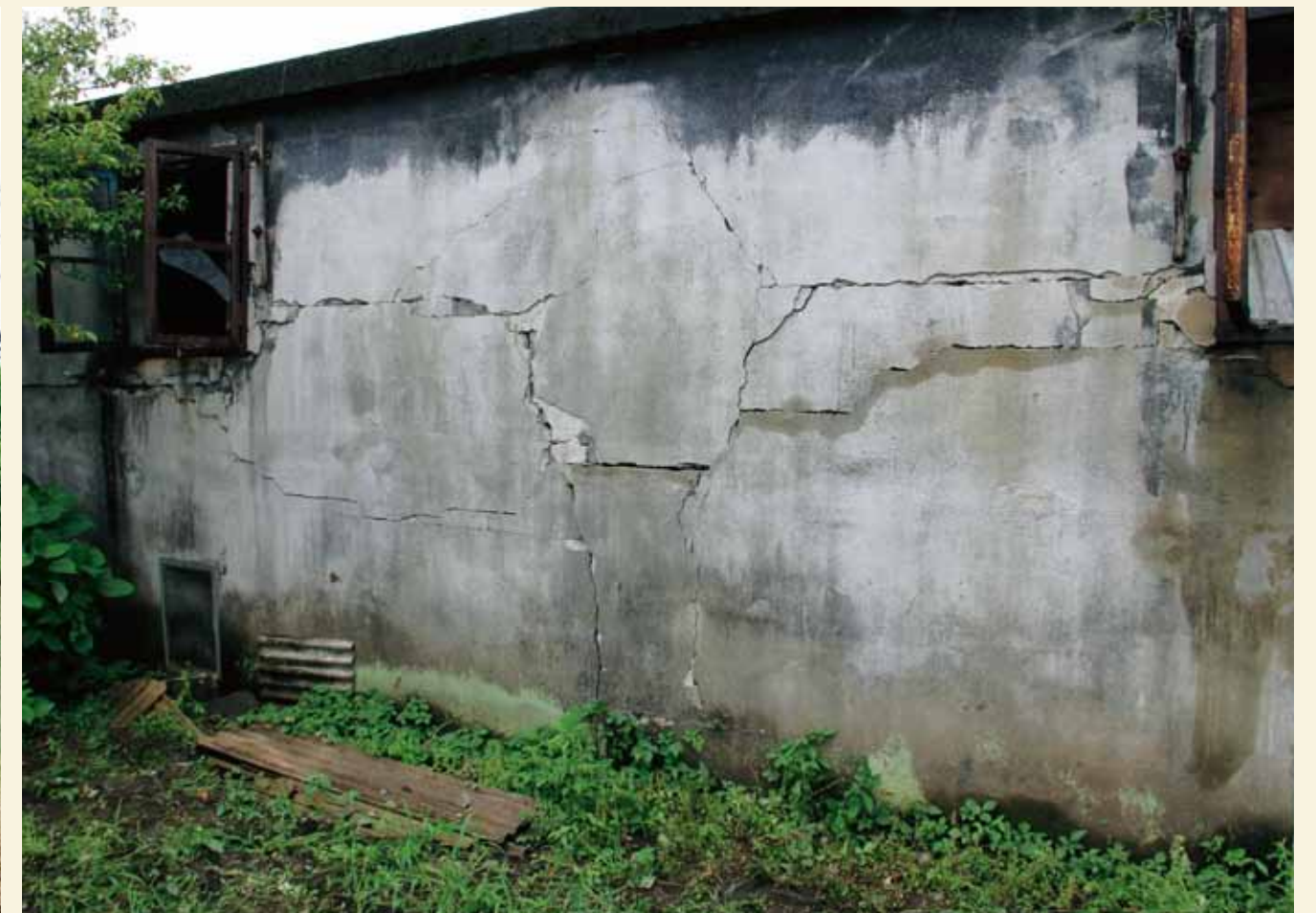
東側壁の亀裂
