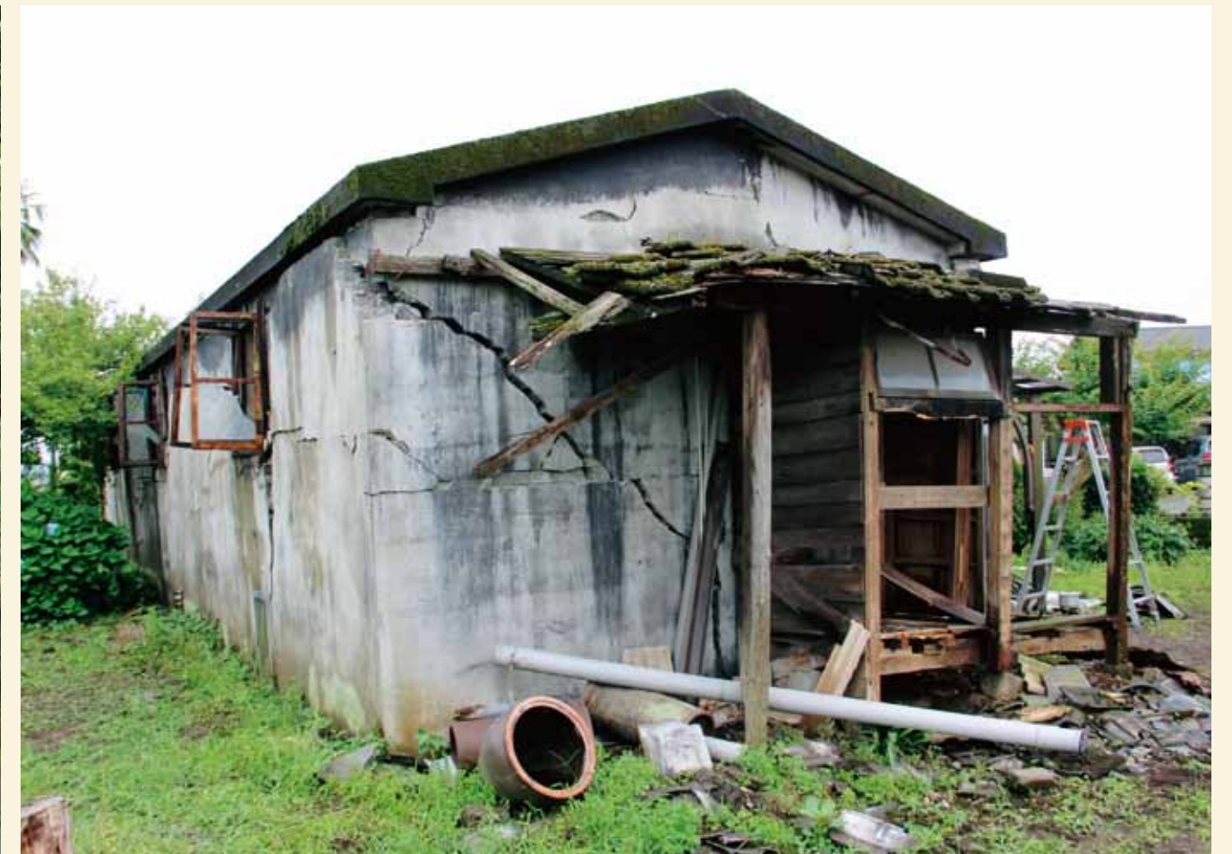
北側被災の様子
