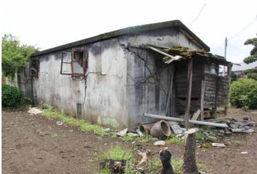
被災し解体された熊本市南区「隈庄飛行場油倉庫」
