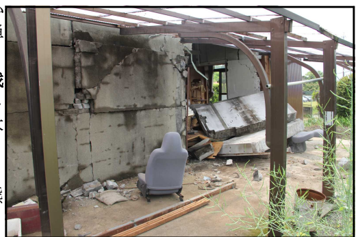
□熊本地震で被災した陸軍限庄飛行場油倉庫の西側壁の崩落状態
