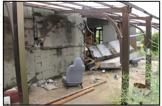
□平成28年熊本地震で被災した陸軍限庄飛行場油倉庫の西側壁の崩落状態
