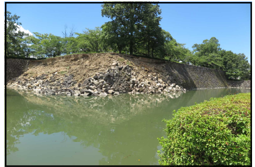
□国指定史跡「八代城」石垣の崩落状況
